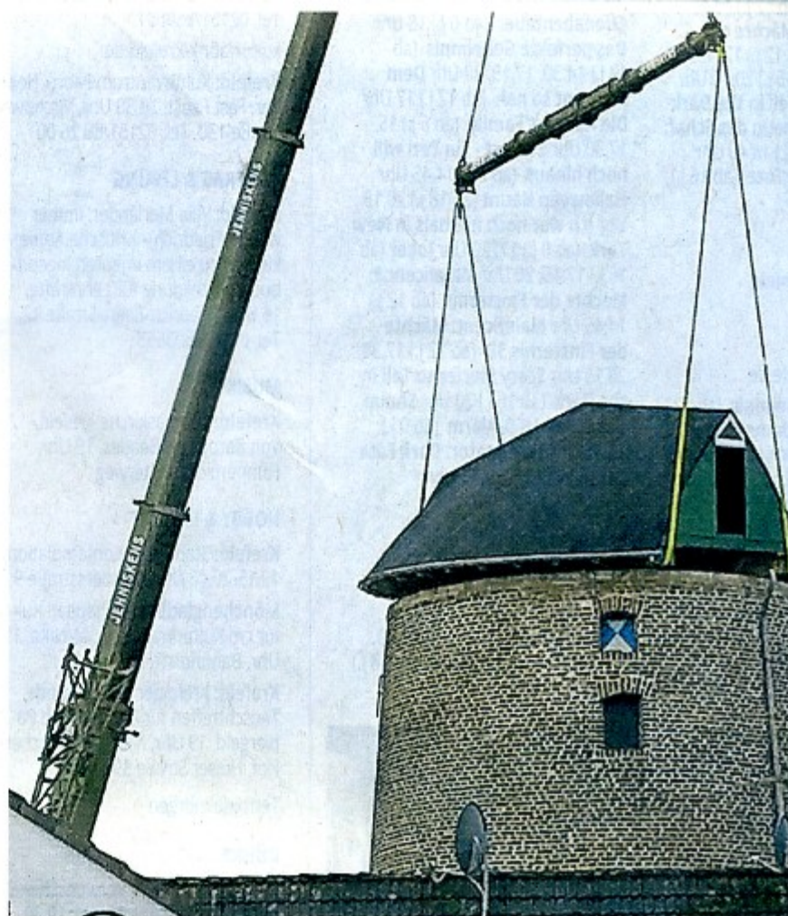
Noch hängt die neue Mühlenkappe am Kran. Zentimeter für Zentimeter wird sie gesenkt und auf den Mauerwerk abgelegt und montiert.
