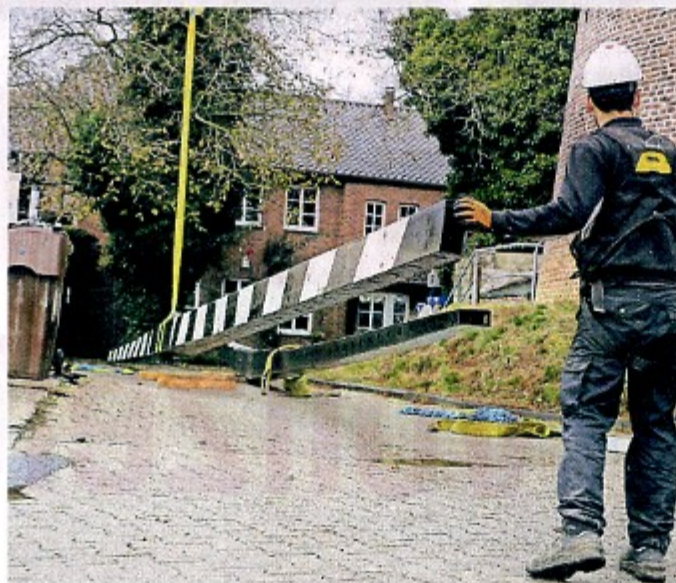
Die neue Kappe sitzt, nun werden die 25 Meter langen Stahlflügel vom Kran in die Höhe gehievt
